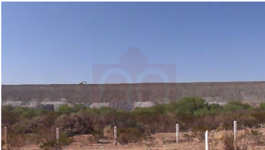
Ilustración 7. Obras junto a la presa de lixiviados. Camino a la localidad de Las Mesas. Fuente: fotografía del autor (abril de 2018).
