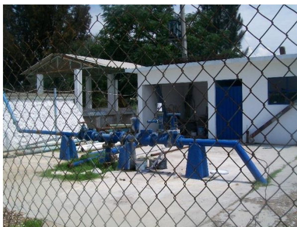
Fotografía 3.1 Pozo de agua potable de la comunidad de El Botho, Cardonal, Hidalgo
