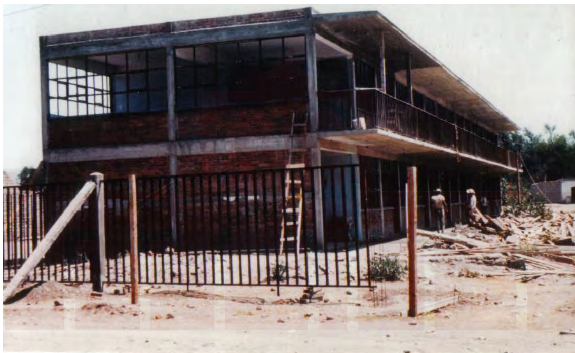
Imagen 9. Construcción de la escuela primaria, Papalotla, Estado México, ca. 1968, Colección particular de Eduardo Pérez Carpinteyro.
